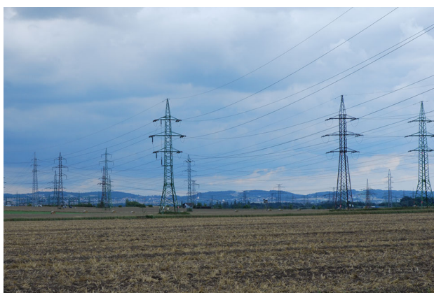
105 Rozvodna a vedení VVN
